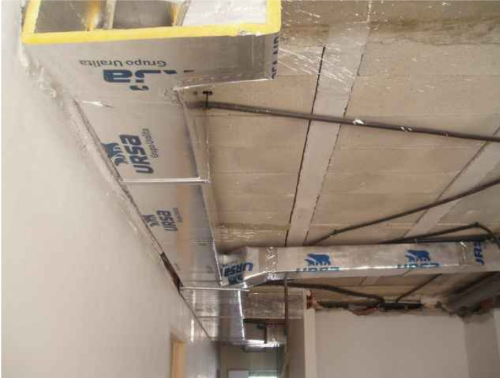
Sistema preinstalacion aire por conducto
